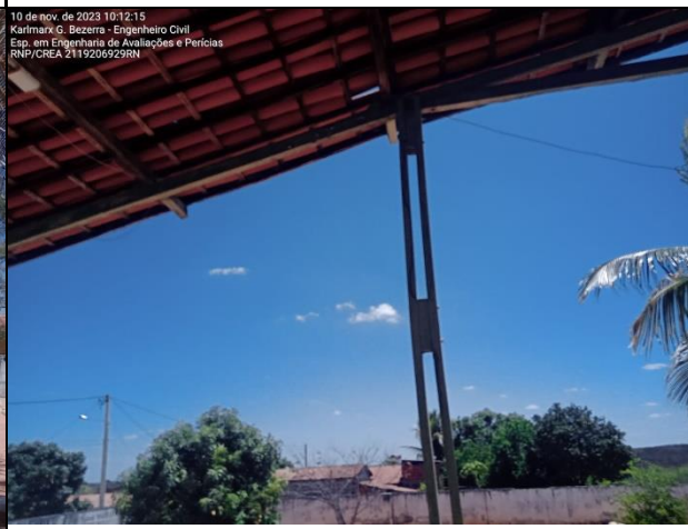
Foto 12: PILARES POSTERIOR COMPROMETIDO.
