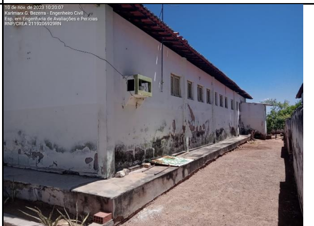
Foto 48: GAMBIARRA NAS INSTALAÇÕES ELÉTRICAS
