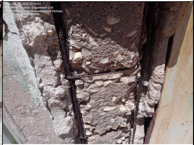
Foto 24: PILARES COM ARMADURA EXPOSTA E ESTRIBOS CORTADOS
