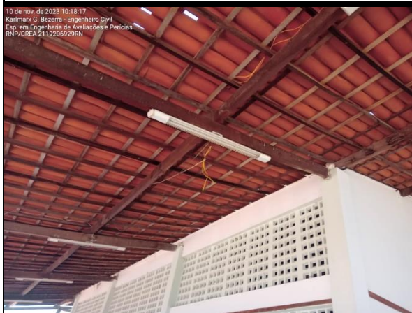
Foto 49: FIOS ELÉTRICOS EXPOSTOS
