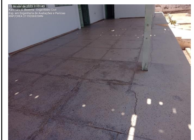
Foto 41: FISSURAS E TRINCAS NO PISO DO TERRAÇO
