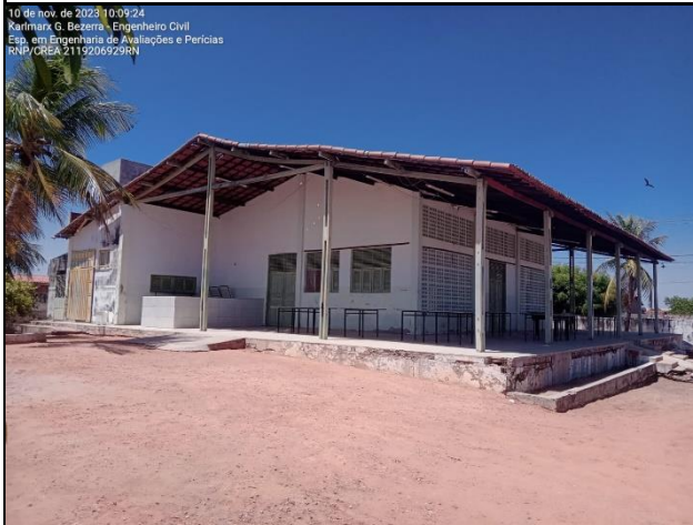
Foto 15: ESTRUTURA DO TERRAÇO COM RISCO DE COLAPSO
