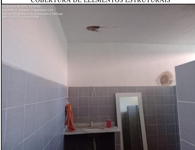
Foto 33: PATOLOGIA NA LAJE DO BANHEIRO
