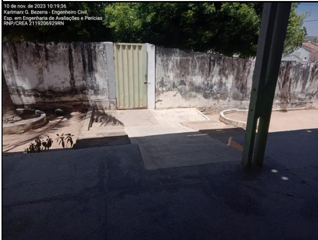
Foto 21: RAMPA DE DEGRAUS DE ENTRADA EM DESACORDO COM A NBR 9050
