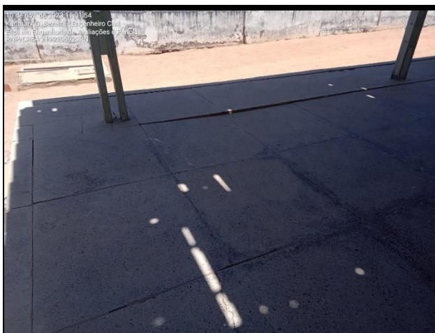
Foto 37: PISO DO TERRAÇO COM FISSURAS E TRINCAS, INCLUSIVE, DESLOCAMENTO LATERAL 8CM
