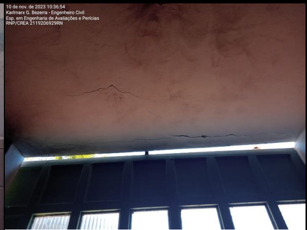
Foto 32: FISSURAS E TRINCAS NA LAJE DA COZINHA
