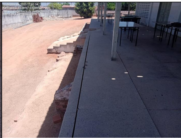
Foto 40: PISO SOFRENDO DESLOCAMENTO LATERAL
