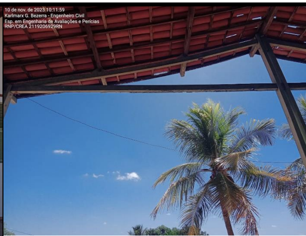
Foto 08: TESOURA FACHADA COMPROMETIDA
