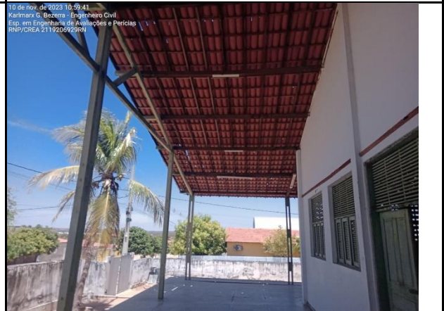
Foto 06: TRAMA DO TERRAÇO COMPROMETIDA.
