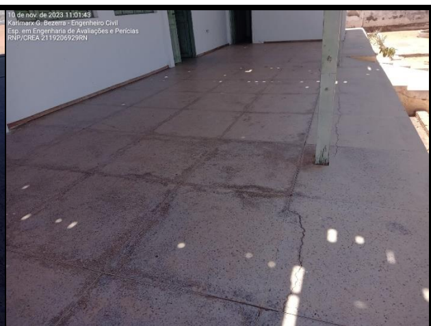
Foto 38: PISO DO TERRAÇO NECESSITA DE RECUPERAÇÃO E REVITALIZAÇÃO
