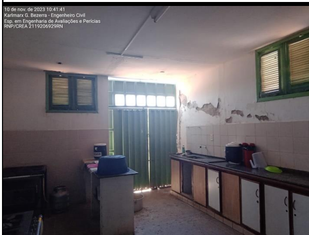
Foto 43: ALVENARIA DA COZINHA COM PRESENÇA DE PATOLOGIAS
