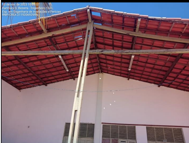
Foto 13: TESSOURA POSTERIOR COM RISCO DE COLAPSO
