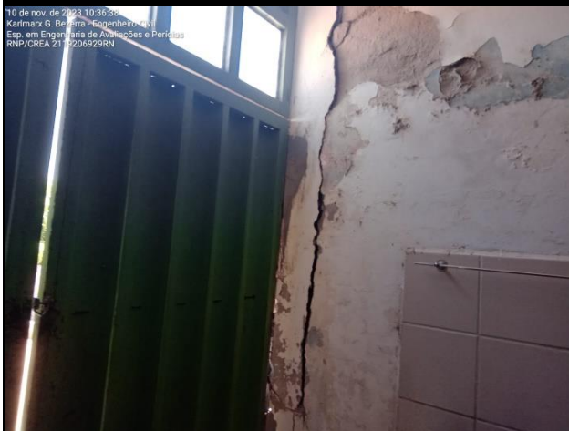
Foto 31: FISSURAS E TRINCAS NAS ALVENARIAS E COBERTURA DE ELEMENTOS ESTRUTURAIS
