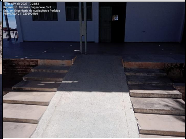
Foto 22: RAMPA DE DEGRAUS DE ENTRADA EM DESACORDO COM A NBR 9050
