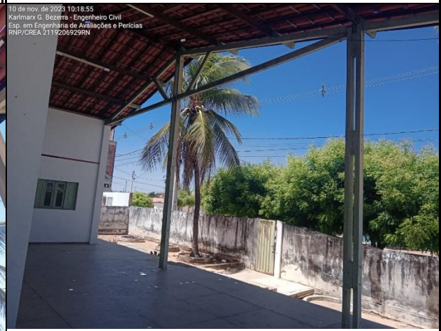
Foto 04: PILARES E TESOURA COMPROMETIDA.
