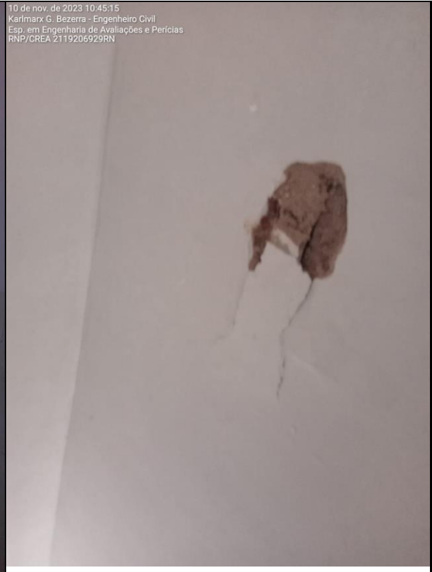
Foto 36: PATOLOGIA NA LAJE DO BANHEIRO 2
