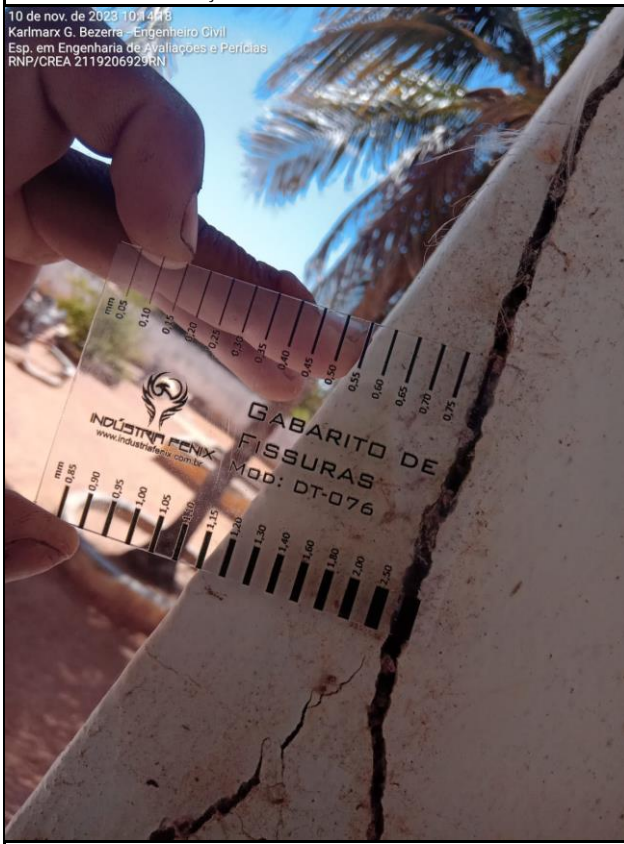
Foto 27: TRINCAS NAS ALVENARIAS
