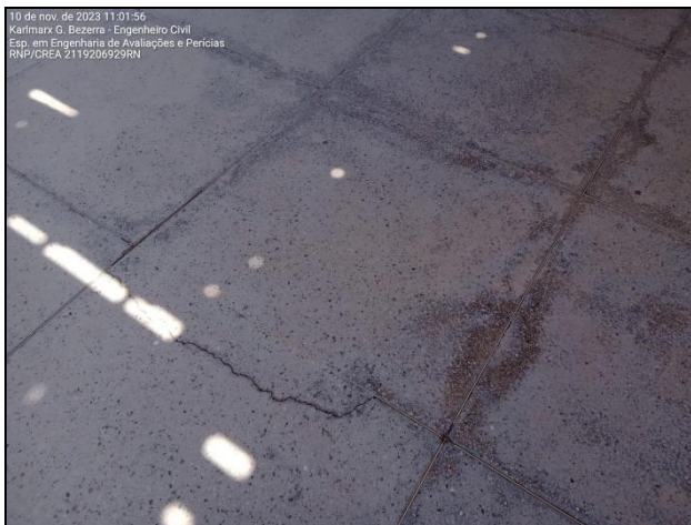
Foto 39: FISSURAS NO PISO DO TERRAÇO
