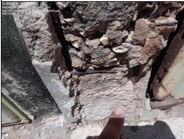
Foto 23: PILARES COM ARMADURA EXPOSTA E ESTRIBOS CORTADOS
