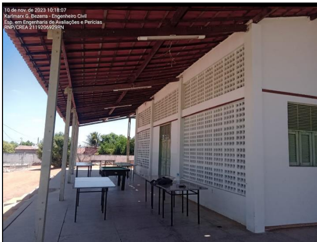
Foto 07: PILARES E TRAMA COMPROMETIDO
