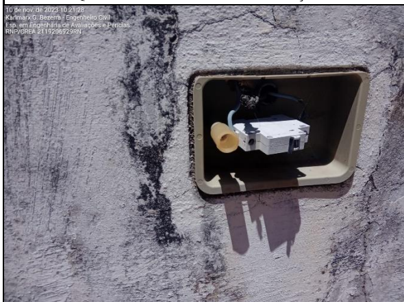
Foto 47: QUADRO ELÉTRICO EM SITUAÇÃO PRECÁRIA.
