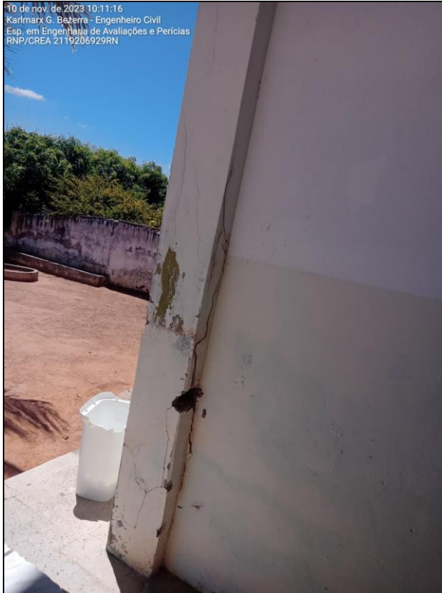
Foto 35: FISSURAS E TRINCAS NAS ALVENARIAS E COBERTURA DE ELEMENTOS ESTRUTURAIS
