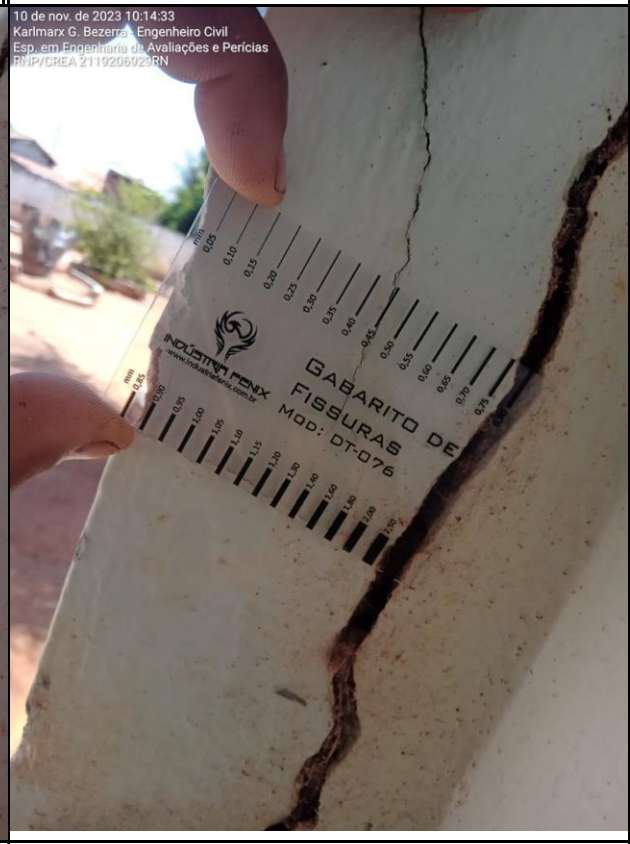
Foto 28: TRINCAS NAS ALNEVARIAS
