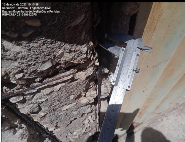
Foto 25: SEÇÃO DA ARMADURA DESGASTADA.
