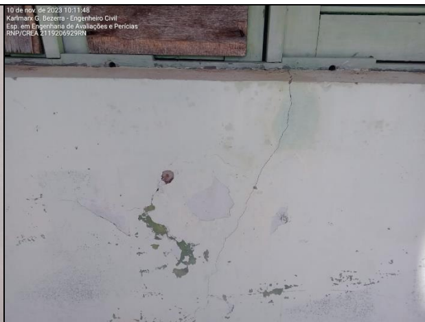
Foto 46: FISSURAS NAS ALNEVARIAS
