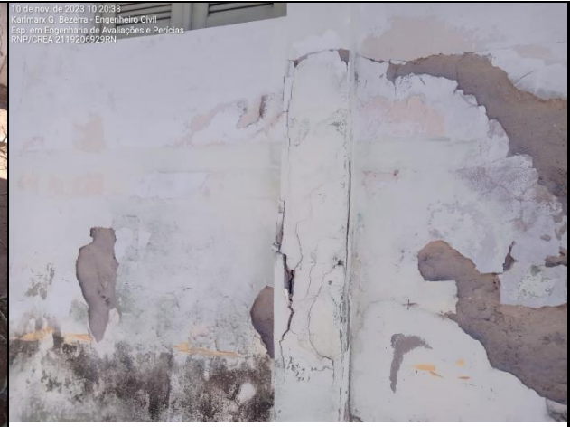
Foto 30: FISSURAS E TRINCAS NAS ALVENARIAS E COBERTURA DE ELEMENTOS ESTRUTURAIS
