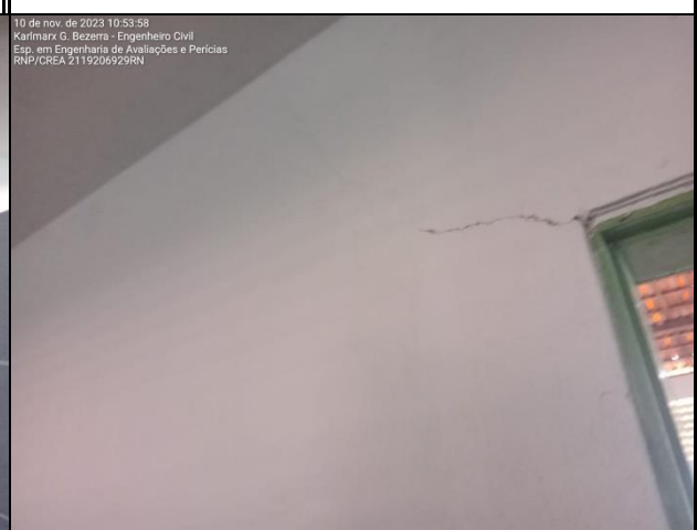
Foto 34: FISSURA NO CANTO DE PORTA
