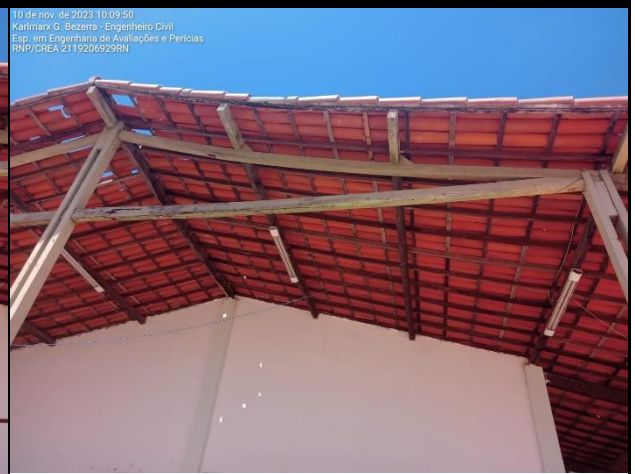
Foto 14: TESSOURA POSTERIOR COM RISCO DE COLAPSO
