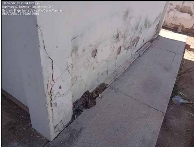
Foto 29: FISSURAS E TRINCAS NAS ALVENARIAS
