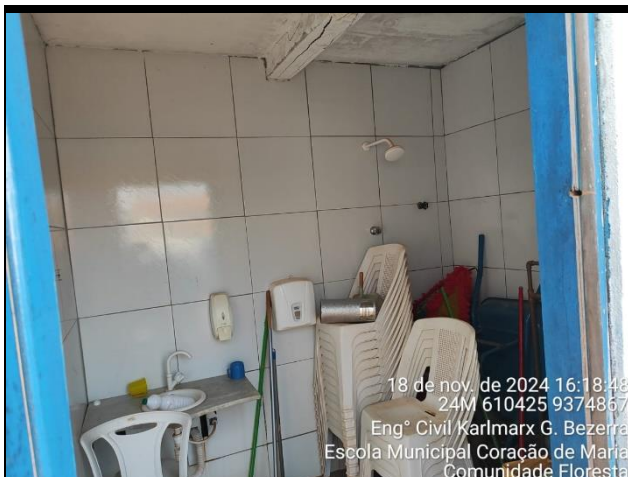
Foto 07: Rachadura na viga e laje deverá ser tratada.
